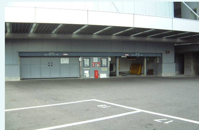
・機械式駐車場
